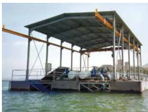
Stazione di pompaggio, Lago di Naro - Agrigento
